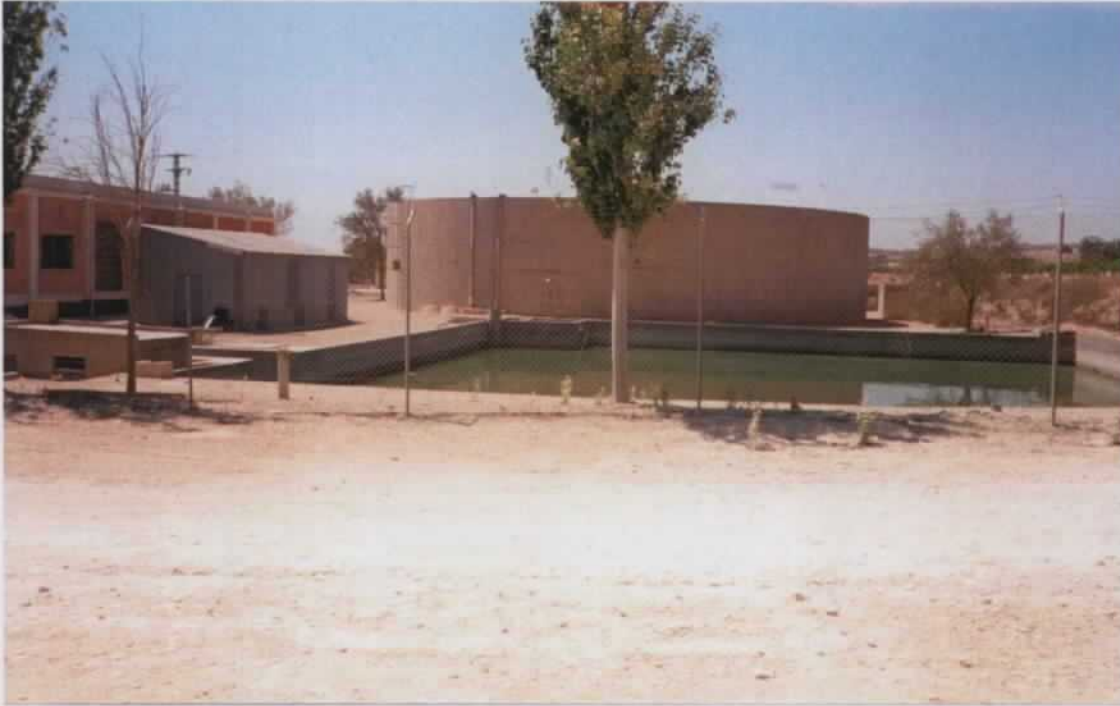
Depósito Regulador Pla Aceituna
